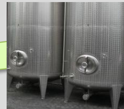
Lagertanks für Zwischenlagerung
